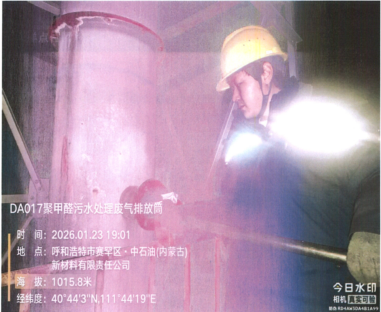
图1 聚甲醛污水处理废气排放筒采样点位照片
