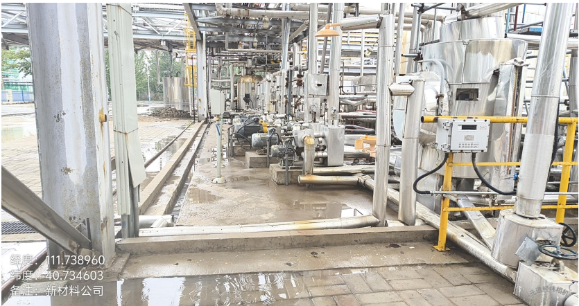
设有围堰的泵区
