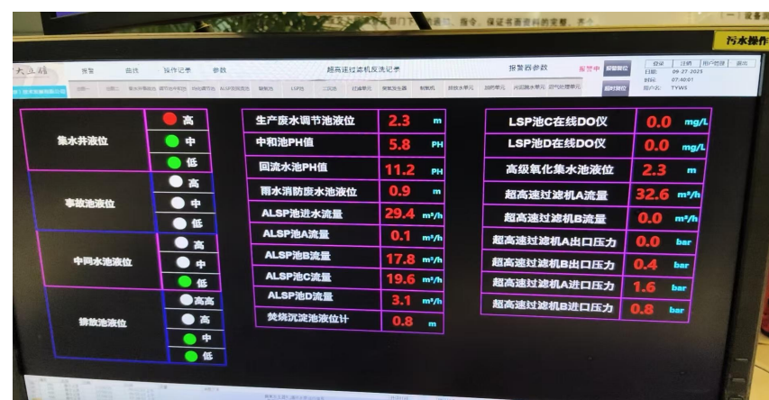
储罐液位显示
