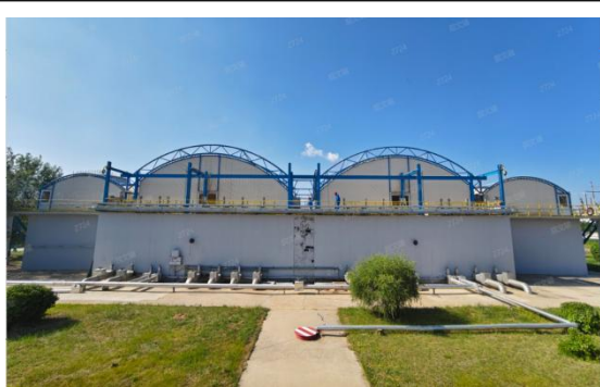
公用工程部污水处理生化池
