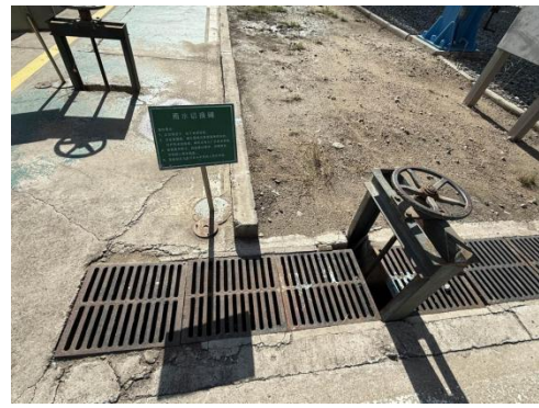
炼油一部催化分馏稳定装置雨污切换
