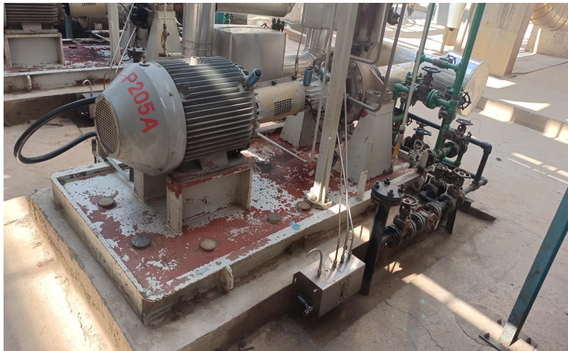
传输泵无泄漏痕迹
