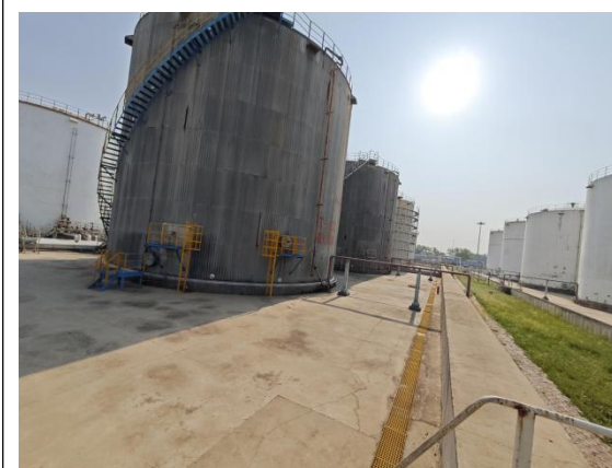
油品部柴油加氢原料罐区
