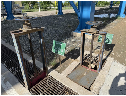
炼油一部催化精制装置雨污切换
