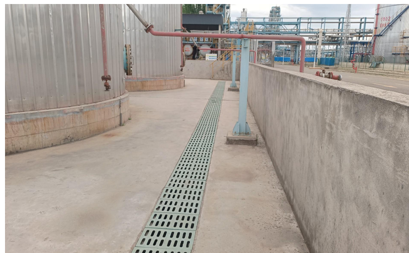
罐区内排水沟、围堤
