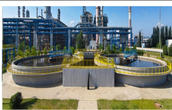
公用工程部污水处理沉淀池
