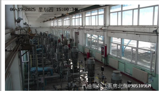
油品部组分二罐区汽柴油调和泵房
