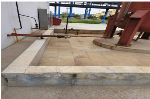
公用工程部 1#循环水场硫酸装卸口
