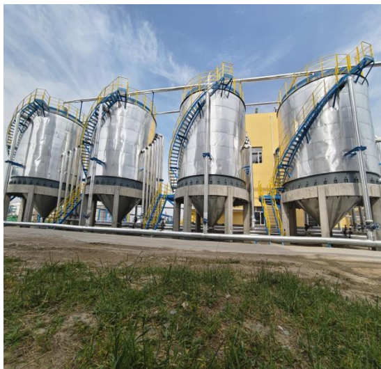
公用工程部污泥浓缩罐 0501/1-T-501A/B/C/D
