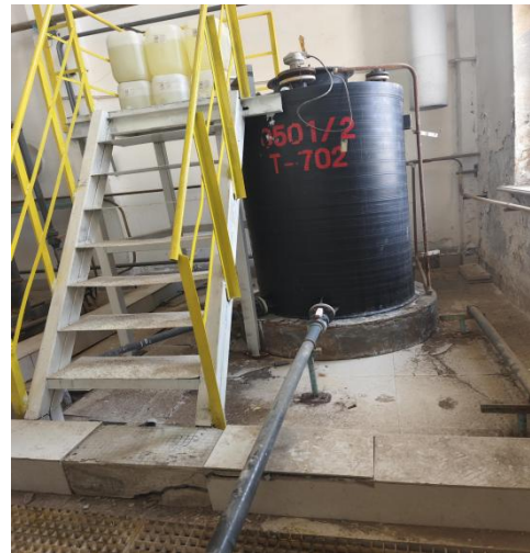
公用工程部次氯酸钠罐 0501/2-T-702
