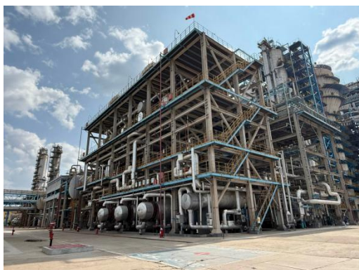
炼油一部催化裂化装置
