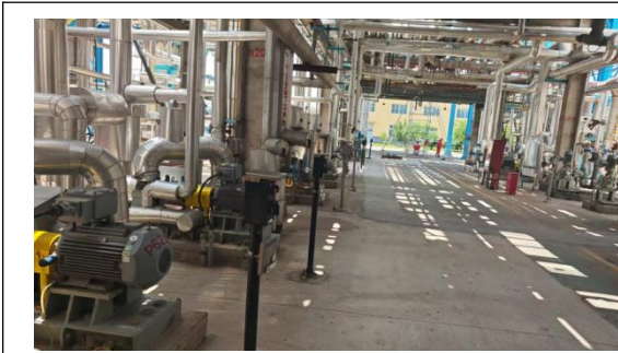
炼油一部催化装置精制管廊泵区
