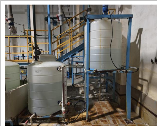
公用工程部还原剂储罐 0713-V16-01/02
