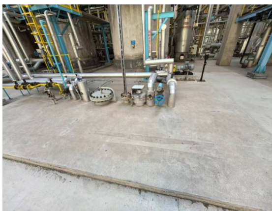
炼油一部地下溶剂回收罐 1234-V-625
