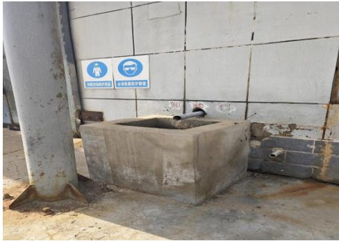
公用工程部除盐水处理站装卸口
