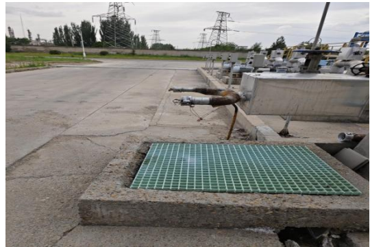
公用工程部污水碱站装卸口
