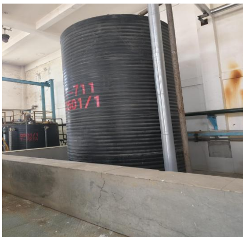
公用工程部碱罐 0501/1-T-711
