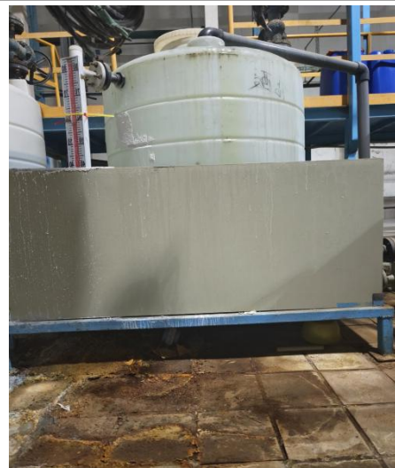
公用工程部盐酸储罐 0713-V13
