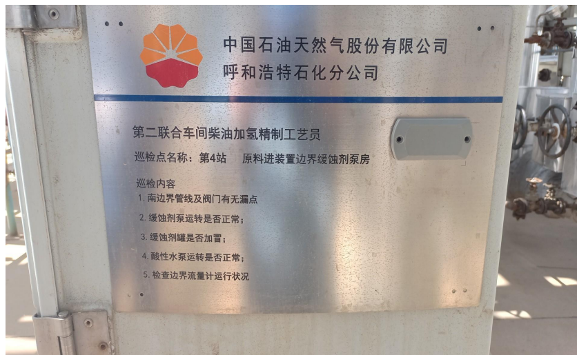
生产装置、传输泵巡检点
