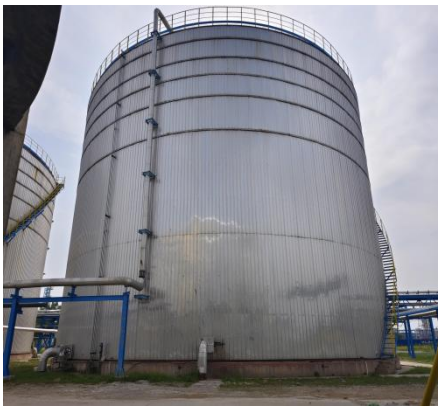
公用工程部事故罐 0501/1-T-101E
