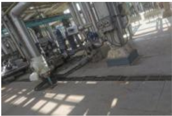
炼油二部煤柴油加氢精制装置雨污切换
