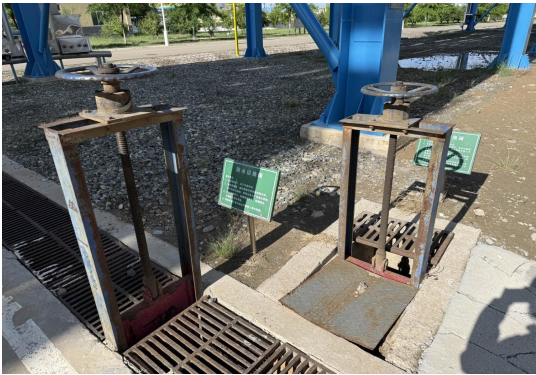
炼油一部催化精制装置雨污切换
