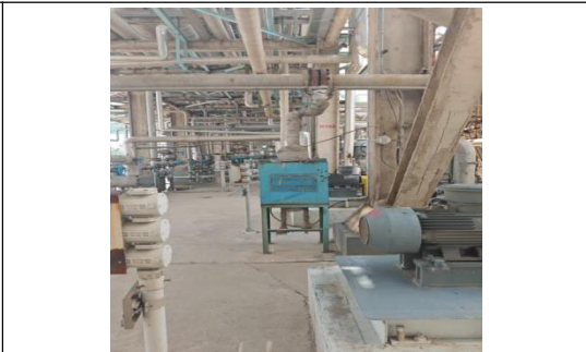
炼油一部气分装置气分管廊泵区
