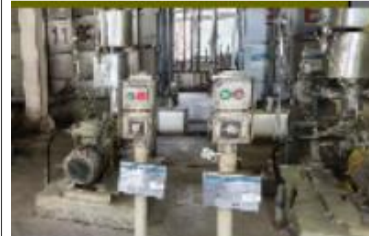
炼油一部常压装置常压泵房
