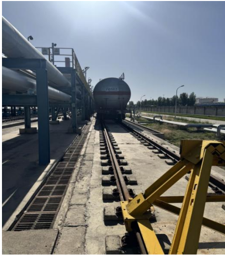
装运部航煤接卸栈台
