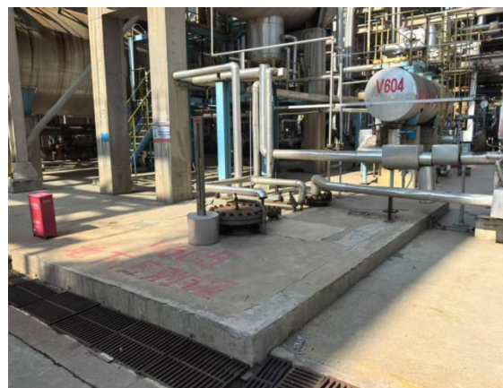
炼油一部地下溶剂罐 1234-V-605
