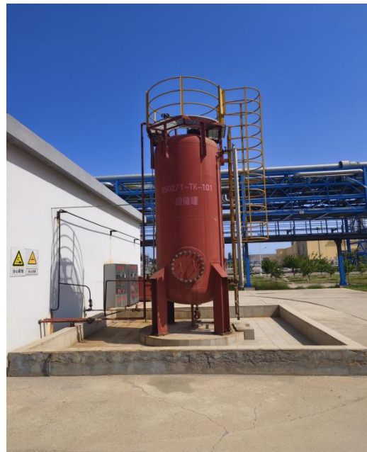
公用工程部硫酸储罐 0502/1-TK-101
