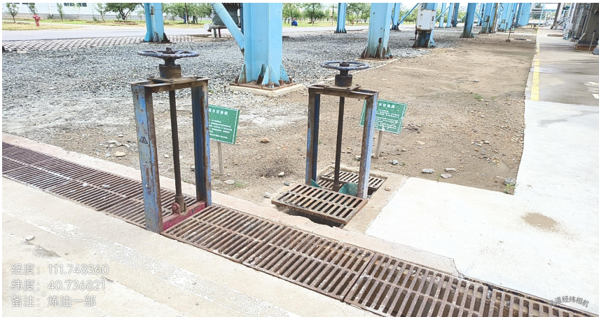
生产装置雨污分流装置
