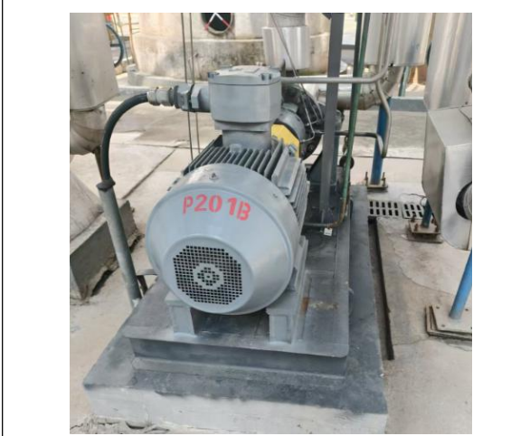
炼油一部 MTBE 装置 MTBE 管廊
