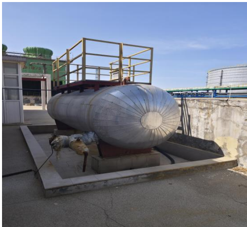
公用工程部储酸罐 0502/2-TK-101
