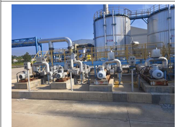
公用工程部碱站
