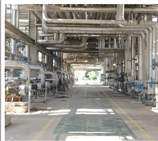
炼油一部催化装置分馏稳定管廊
