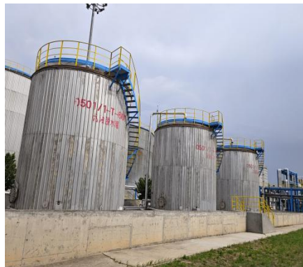
公用工程部污油罐区 0501/1-T-601A/B/C
