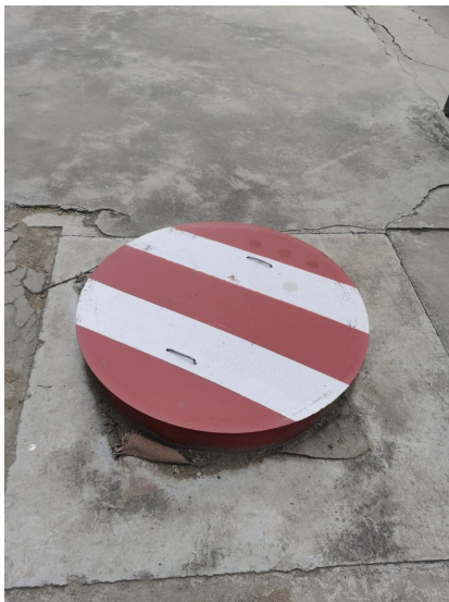
炼油二部苯抽提装置污水排放系统
