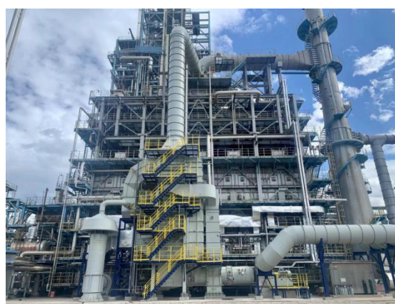
炼油二部连续重整装置
