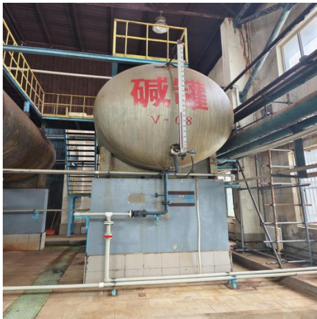
公用工程部碱罐 0713-V-08
