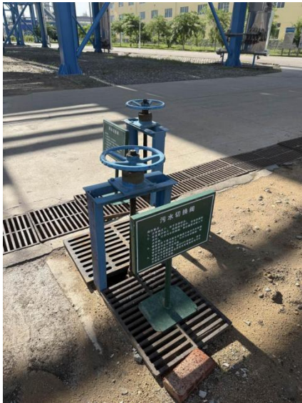
炼油一部催化反再装置雨污切换
