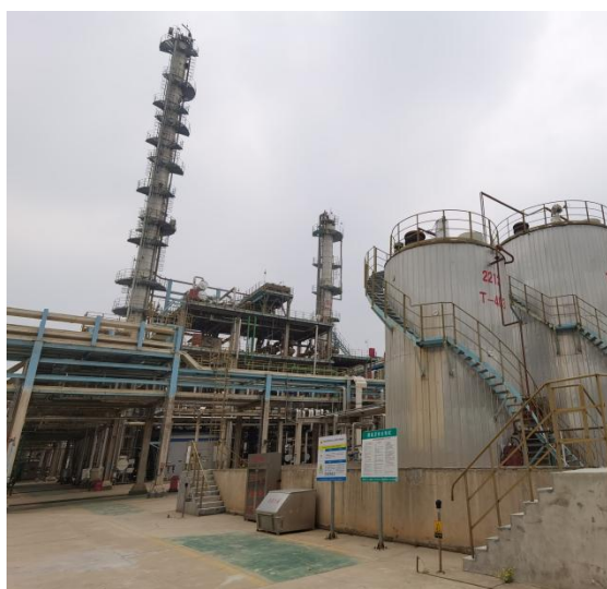
炼油二部苯抽提装置
