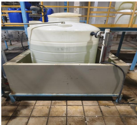
公用工程部次氯酸钠储罐 0713-V12
