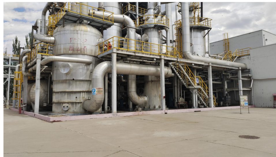
装置普通阻隔设施
