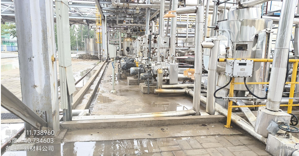
设有围堰的泵区
